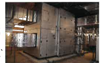
写真-10 外気処理空調機
