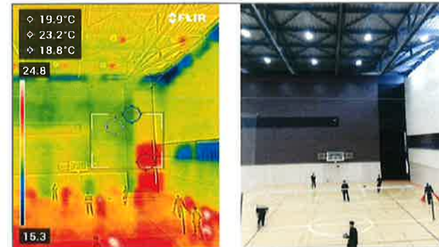
写真-11 冬季(外気温度-8℃時)状況
