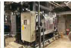
写真-O8 冷温水発生機
