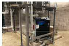
写真-O7 潜熱回収温水器
