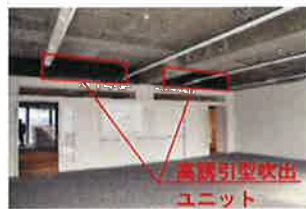
写真-15 教室への設置状況
